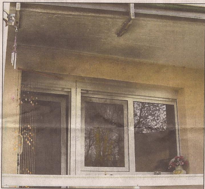
Die Brandspuren innerhalb und außerhalb der Wohnung können beseitigt werden, emotionale Wunden bleiben.
